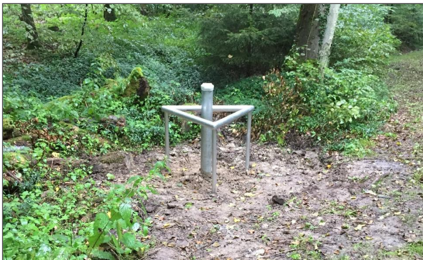
Abb. 4: Grundwassermessstelle mit Anfahrtschutz.
