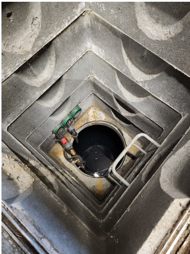
Blick in den Zwischenbehälter
