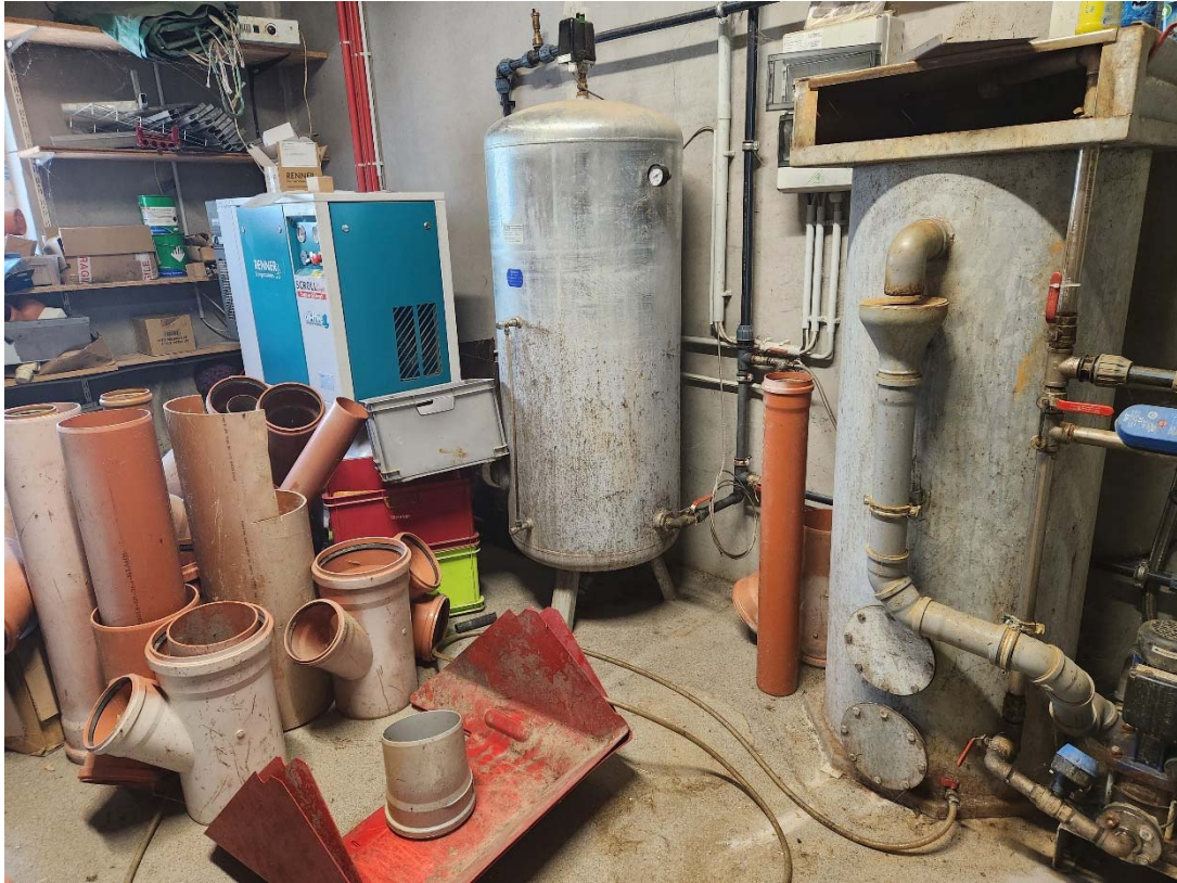
Anschlussraum mit Wasserfilter und Druckbehälter
