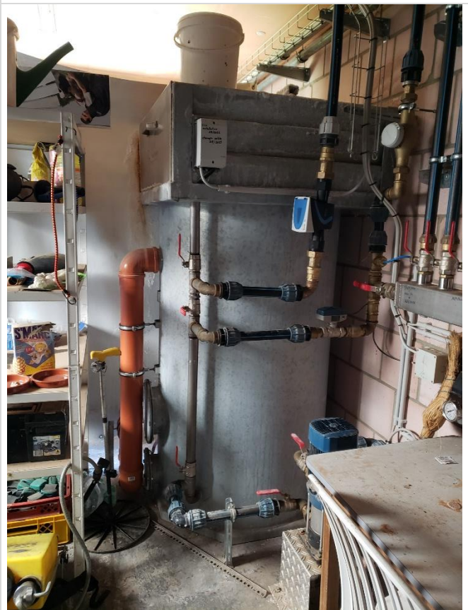
Photo 4 : Unité de traitement d'eau du puits
