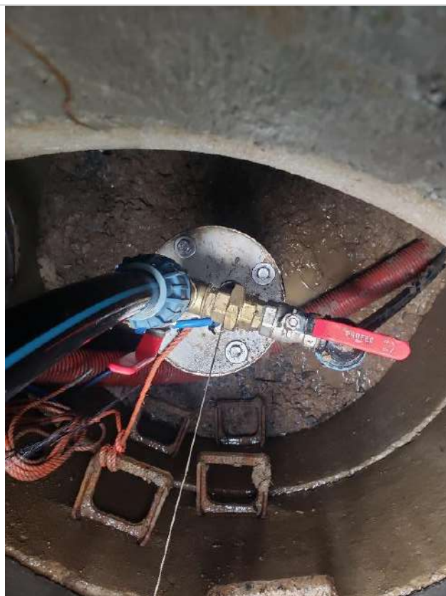
Photo 6 : Equipement de tête du forage FRE-510-48.
