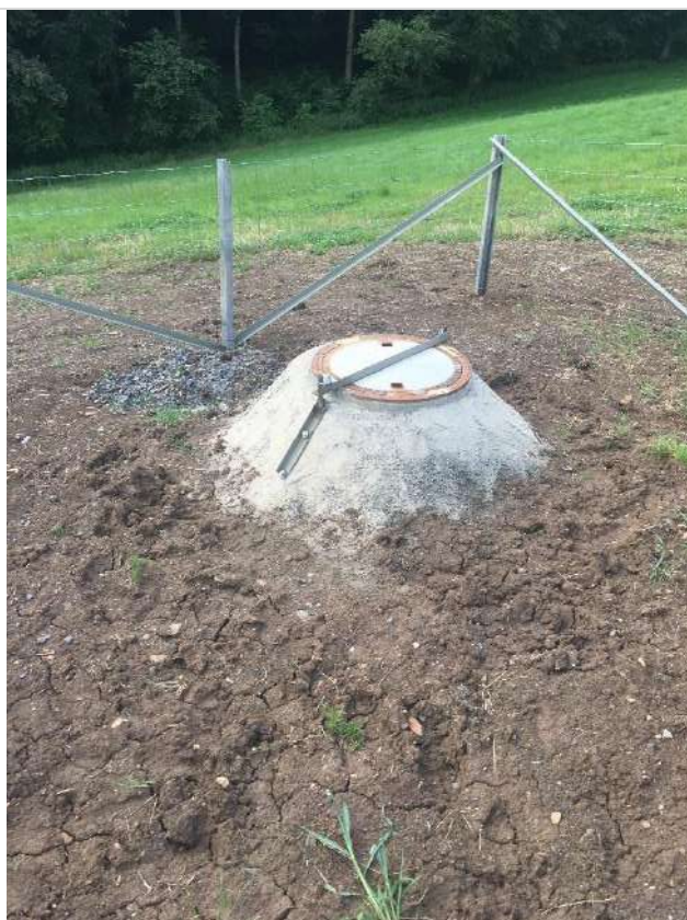
Photo 6 : regard du forage FRE-510-48 équipé de cadenas.
